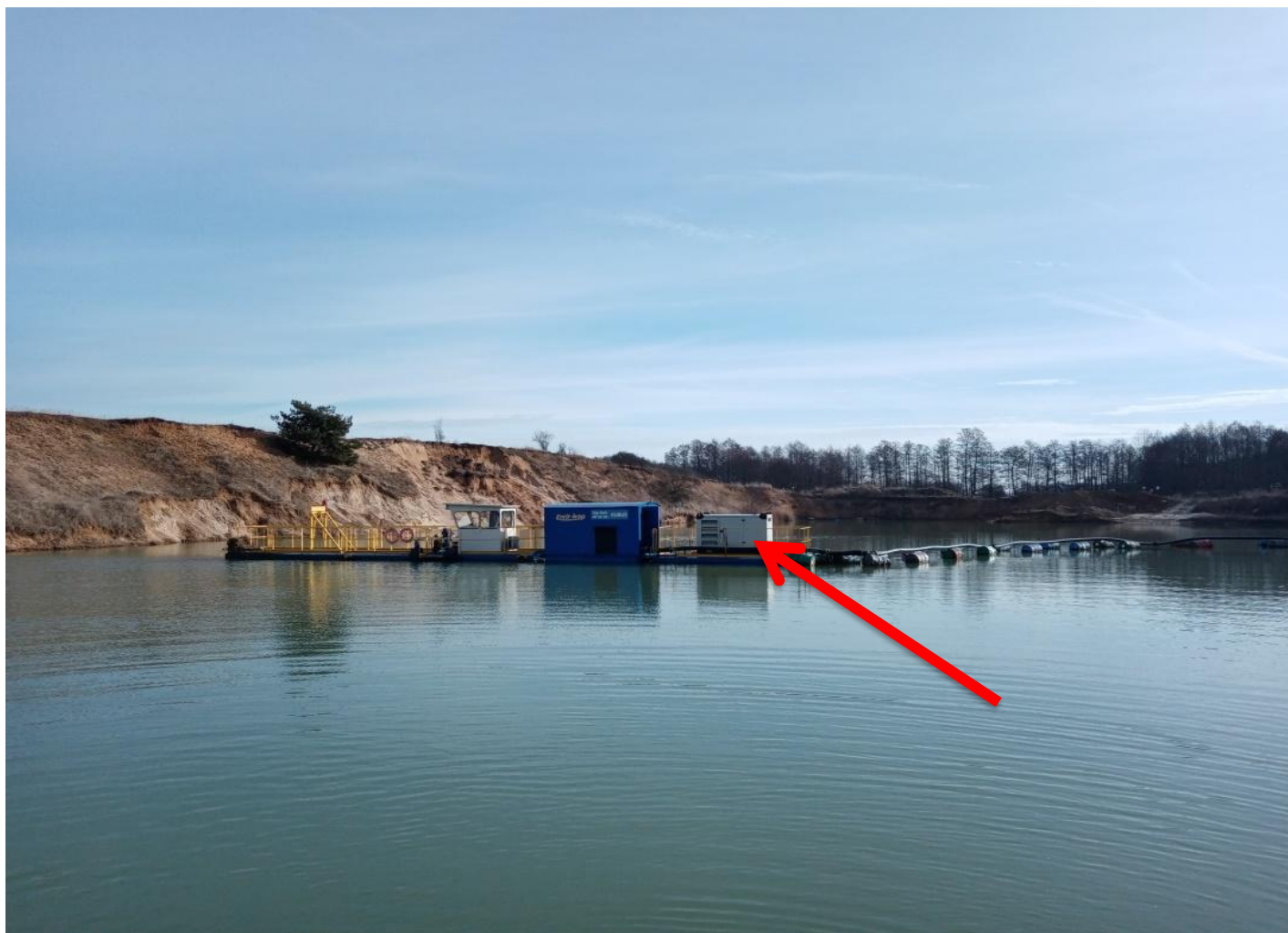
Aggregat prądotwórczy pogłębiarki typ 300/250 10/8 FGH WARMOONO.
