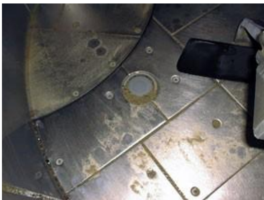
Czujnik zamontowany w mieszalniku
