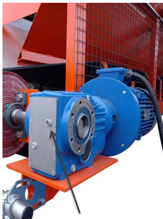
Oczko kontrolne w obudowie przekładni.
