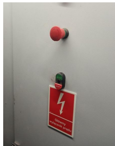
Wyłącznik na drzwiach szafy rozdzielczej.
