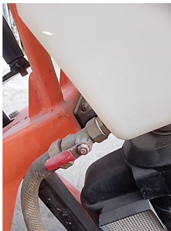
Zawór przy zbiorniku na wodę.
